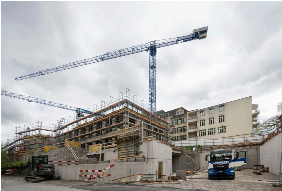
Die Baustelle des Regionalen Pflegezentrums Baden an der Wettingerstrasse. Bild: Alex Spichale
