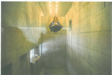
Der Greifarm des Krans hebt Müllschlacke aus dem Kehrichtbunker in den Verbrennungsstrakt.
